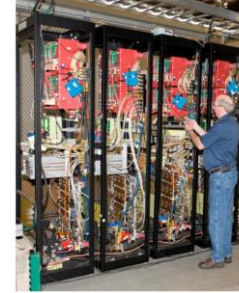
2011 GE 1 MW AC-AC SST w. 10 kV SiC
